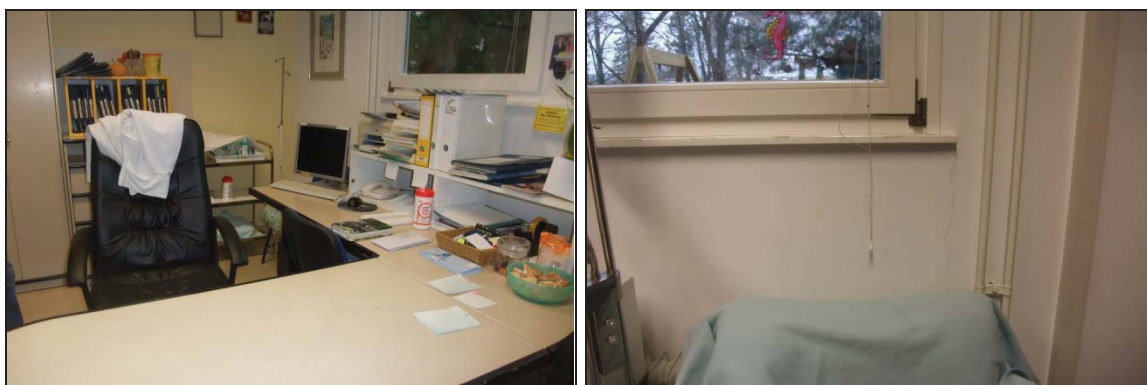
Slika 40: Poškodovana talna obloga in kopalnica
