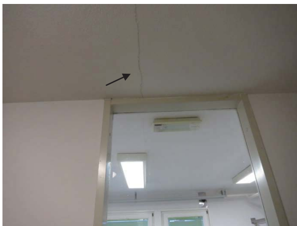
Slika 22: Razpoka v stropni konstrukciji
