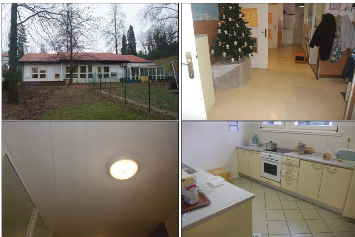
Slika 34: Soba za logopeda in poškodovana stenska obloga
